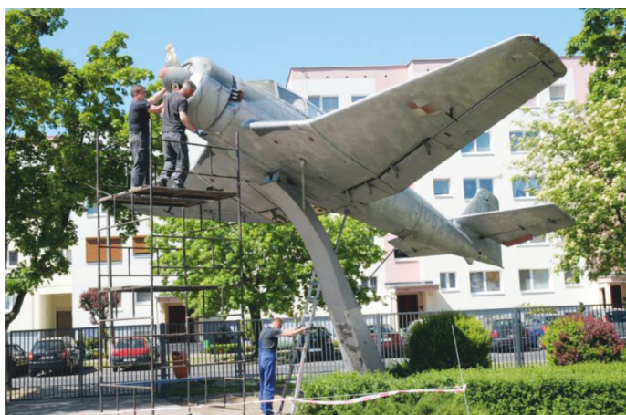
W maju rozpoczął się demontaż śmigła i wycinanie uszkodzonych fragmentów poszycia samolotu
